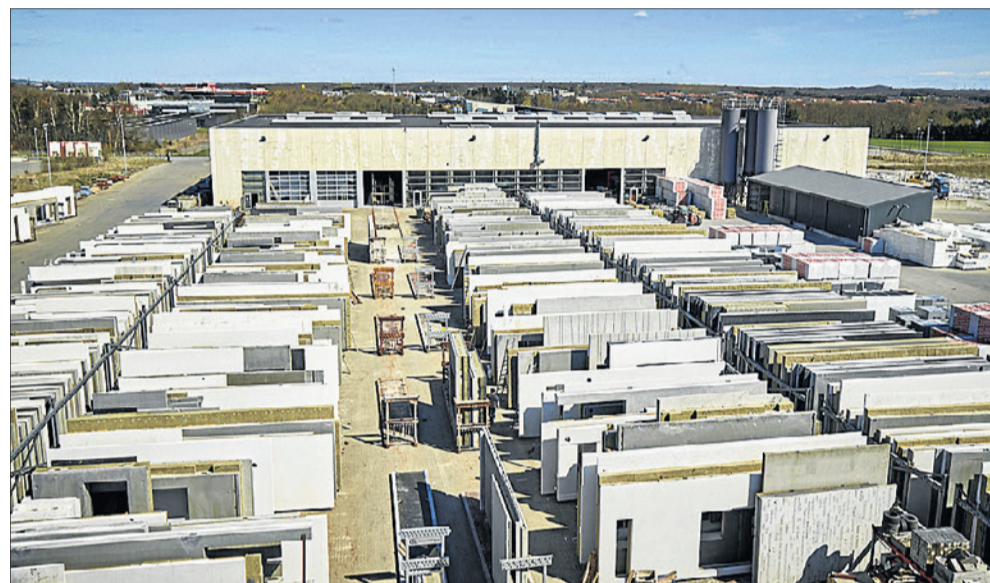
I løbet af det kommende år fordobler virksomheden sin kapacitet, idet man er ved at opføre et spejl af sin nuværende produktion lige ved siden af den eksisterende i Randers. (Foto: Confac A/S)
